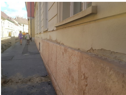
-A nedvesedés miatt károsodott vakolat-
